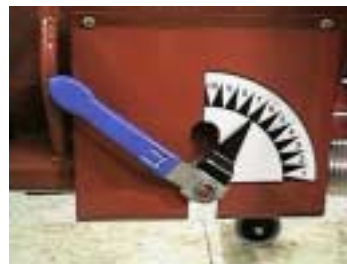
Fig 6 bilden visar den kulventil som reglerar luftflödet
