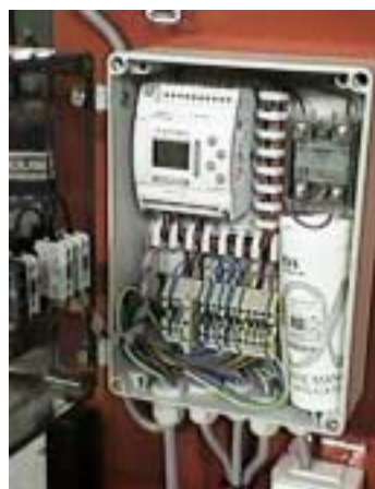
Fig4 Bilden visar styrboxen med en påkostad reglerteknik. Det är i princip möjligt att ställa de flesta parametrarna för att styra förbränningsprocessen.
