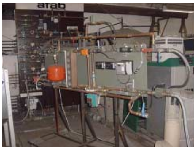
Bilden ovan visar Äfab:s kylrigg där lasten styrs via en framtagen lastcykel som täcker 20 drifttimmar
