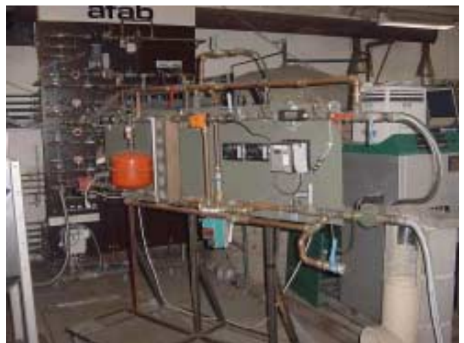
Bilden ovan visar Äfab:s kylrigg där lasten styrs via en framtagen lastcykel som täcker 20 drifttimmar
